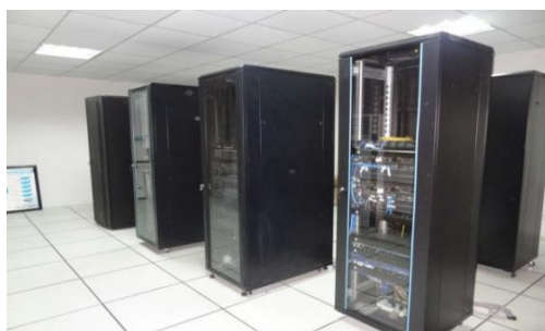
图 33 校园数据中心
